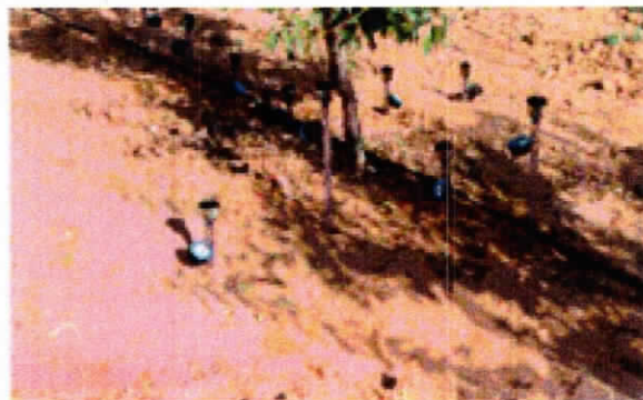
Figure 18. Installation de capteurs capacitifs et résultats de mesures à différents niveaux.
